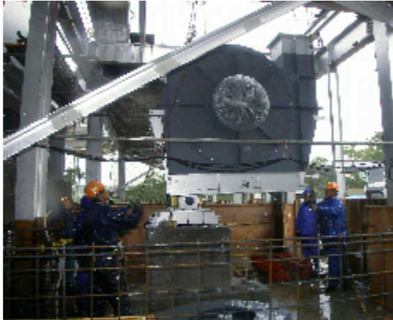
③ 誘引送風機設置状況
