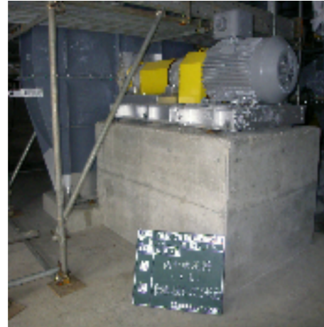
② 誘引送風機電動機
