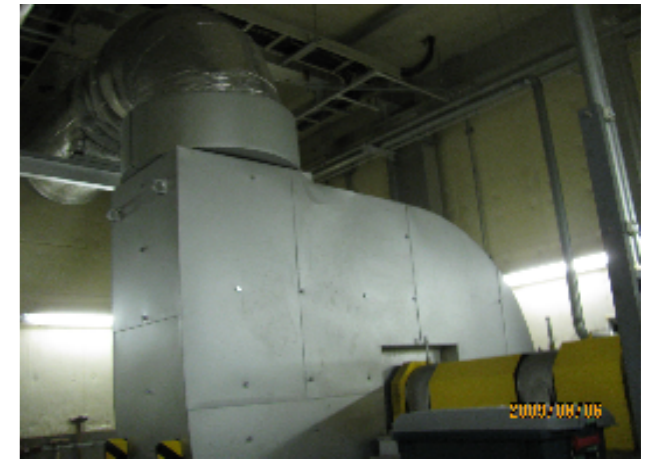
⑤ 誘引送風機外観
