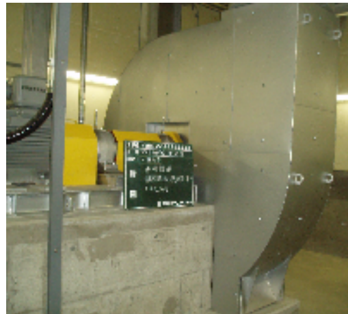
① 誘引送風機外観
