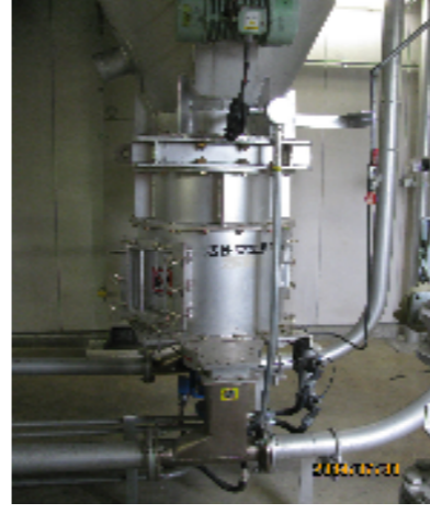
かっせいたん ていりょう きょうきゅう そうち ④活性炭定量供給装置
