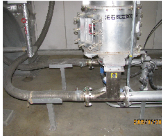
しょうせっかい ていりょう きょうきゅう そうち ①消石灰定量供給装置
