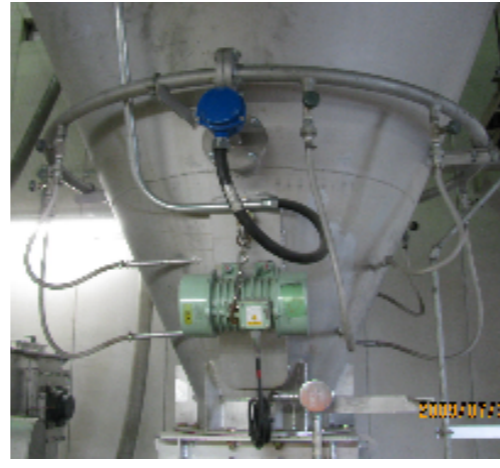
しょうせっかい ちりゅう そう ③消石灰貯留層
