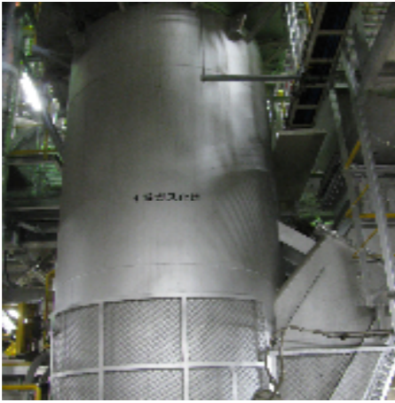
⑧ガス化炉
