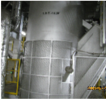
③ガス化炉外観 かる がいかん
