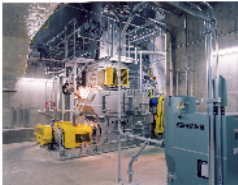
① 給じん装置室
