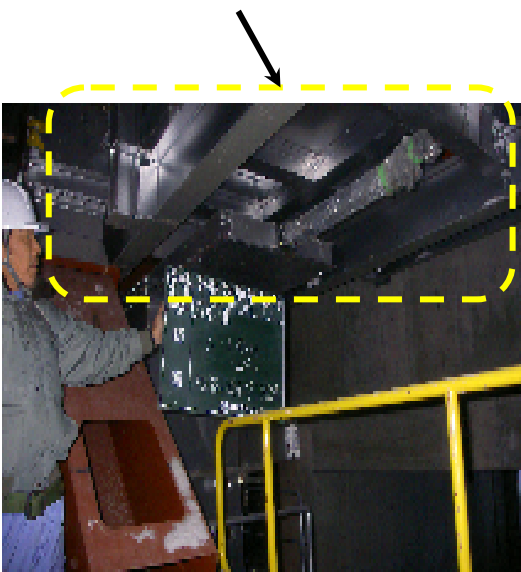
②シール機No1本体
