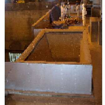
④プラント内の投入 ホッパー
