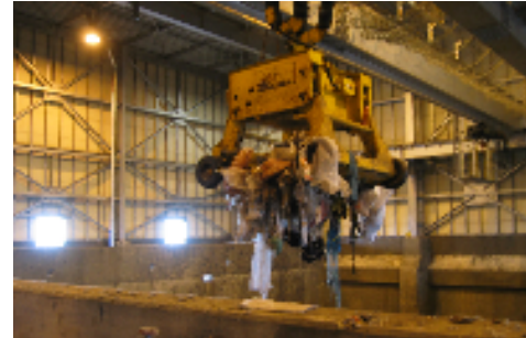
③ごみを持ち上げるクレーン
